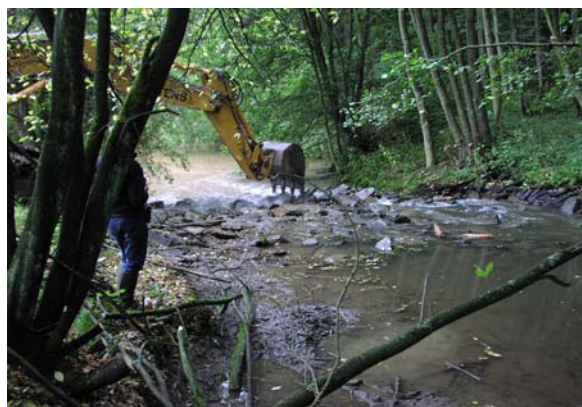
Herstellung einer Sohlgleite im Bereich des ehemaligen Wehrkörpers zur Anbindung des einmündenden Aulbachs
